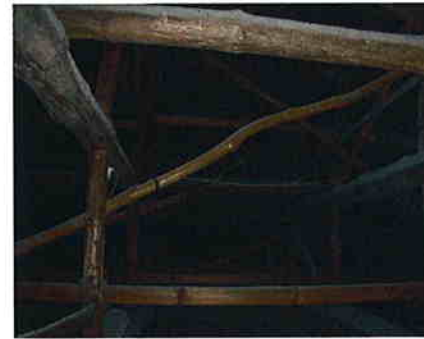
③小屋組の経年、雨漏り等による劣化 構造上の不利
