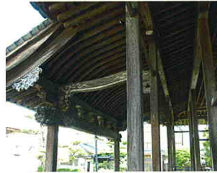
①柱の傾き
