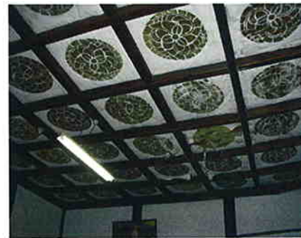
④天井のたわみ、雨漏り
