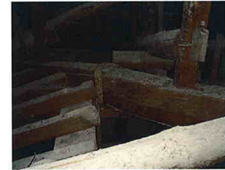
③小屋組の経年、雨漏り等による劣化 構造上の不利
