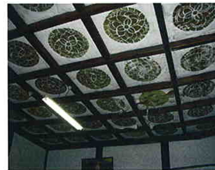
④天井のたわみ、雨漏り
