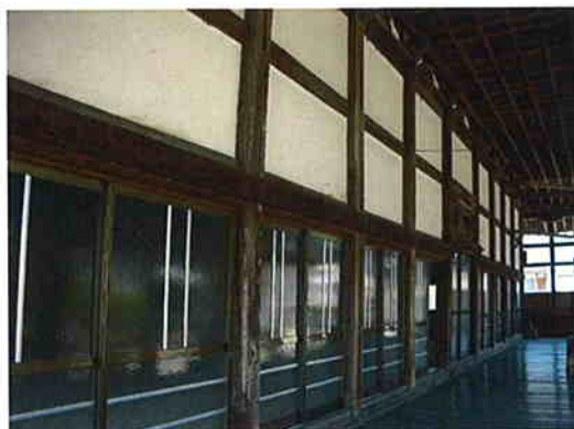
外陣東壁面 柱が正面方向に傾いている
