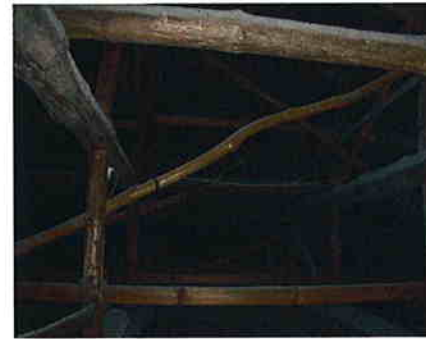
③小屋組の経年、雨漏り等による劣化 構造上の不利
