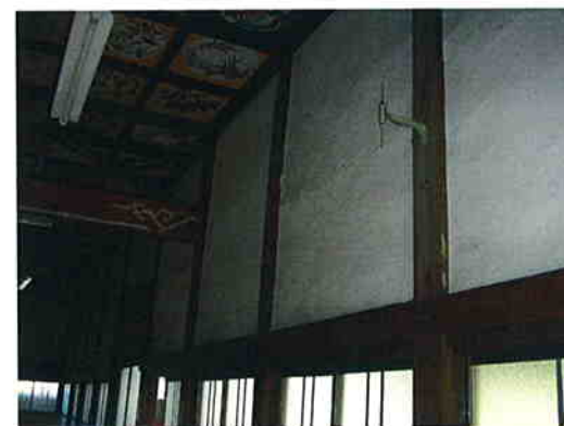
外陣東壁面内側 貫部分でひびが入っている
