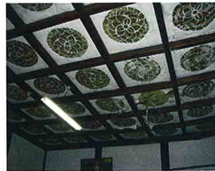
④天井のたわみ、雨漏り
