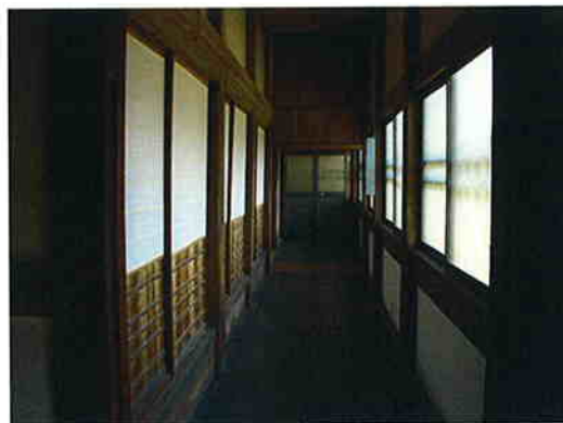
南面廊下 柱が傾いていたため敷居、鴨居、建具も傾く 柱を加工して納まるようにしてある建具も見られる
