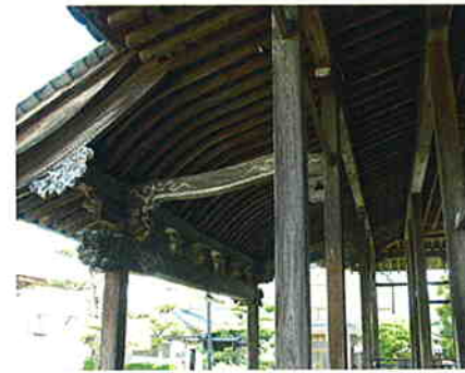
①柱の傾き
