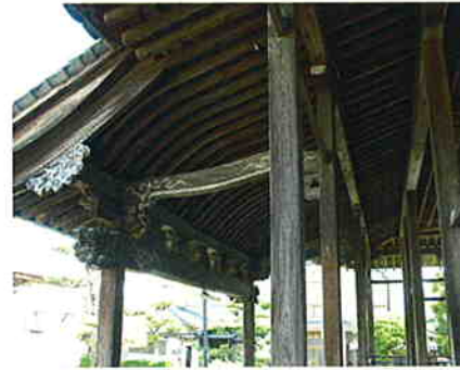
①柱の傾き
